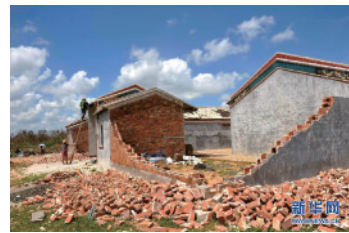
图4 “威马逊”台风灾后墙体破坏 ①
